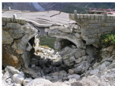
Abb. 2: Zerstörte Brücke nach einem Starkregen in den Schweizer Alpen. Foto: Berni
