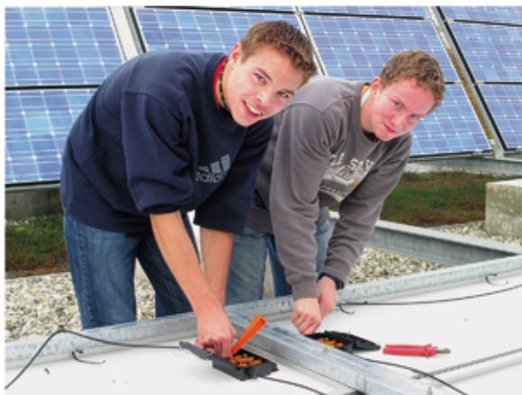
Abb. 1: Schüler installierten 2004 am Ferdinand-Porsche-Gymnasium in Stuttgart eine Photovoltaikanlage
